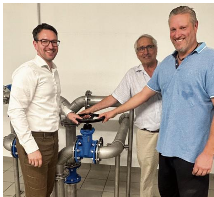
Nehmen den neuen Hochbehälter mit der Hand am Schieberad symbolisch in Betrieb: (von links) Bürgermeister Björn Kornmüller, Diplom-Ingenieur Peter Leuze und Wassermeister Thomas Röder. Foto: Harald Ehrler
