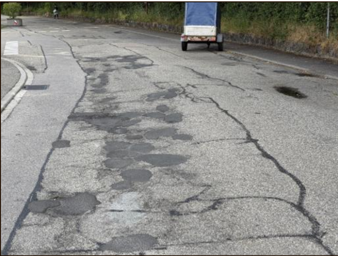
Die Wilhelm-Roether-Straße ist sanierungsbedürftig. Foto: Hans-Dieter Stöber, Gemeinde Karlsbad
